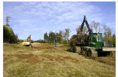
Schlägerung einer Pistenstrasse: Hochficht Bergbahnen GmbH - Forstamt Stift Schlägl Mengenanteil: 85% Biomasse, 15% Faserholz
